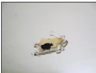
Photo N° 27 ECH-N°021 Rdc - Salle 2 Plafond Polystyrène + plâtre + peinture
