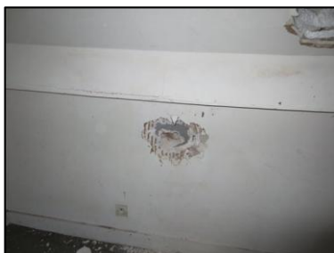
Photo N° 40 ECH-N°033 Salle 2 +1 Mur gauche Plâtre + peinture
