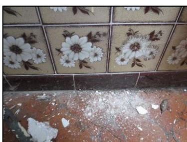
Photo N° 46 ECH-N°039 Salle d'eau +1 Murs Colle pinthe
