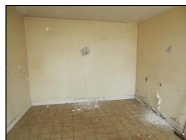
Photo N° 7 ECH-N°003 Rdc - Cuisine Mur face Polystyrène + plâtre + peinture
