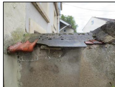
Photo N° 66 ECH-N°047 AMIANTE CIMENT Cour Mur Plaques planes (Fibres-ciment)
