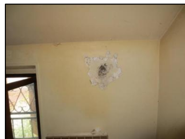
Photo N° 38 ECH-N°031 Salle 2 +1 Mur droite Plâtre + papier peint + peinture
