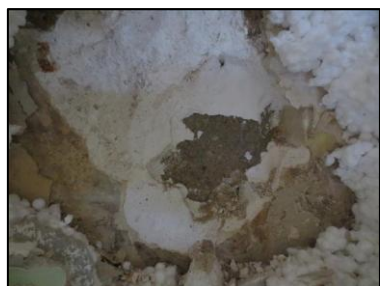
Photo N° 14 ECH-N°004 Rdc - Cuisine Mur face Béton + plâtre + peinture
