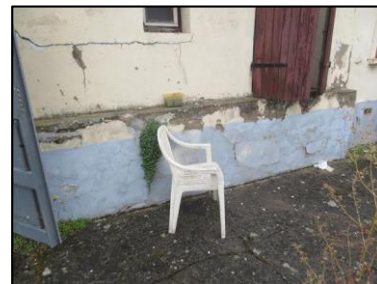
Photo N° 63 ECH-N°053 Maison Soubassement façade Béton + peinture
