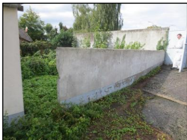
Photo N° 61 ECH-N°051 Cour Muret Béton
