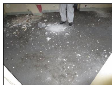
Photo N° 35 ECH-N°028 REVETEMENT DE SOL Salle 1 +1 Plancher Colle moquette
